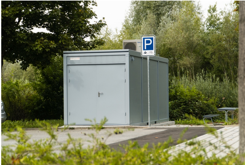
Abbildung 13: Container mit Batterie, Leistungselektronik und Kommunikationstechnik 31
