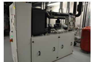
Abb. 1: Combitherm Kältemaschine im Z3
